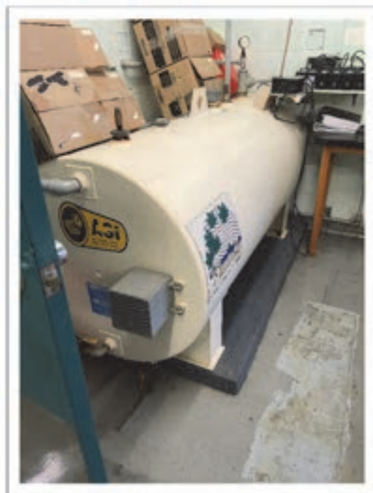
Photo 19 : Réservoir de carburant (diesel) pour la génératrice dans l'usine de traitement (secteur 1125, avenue Saint-Édouard) – 17 décembre 2020
