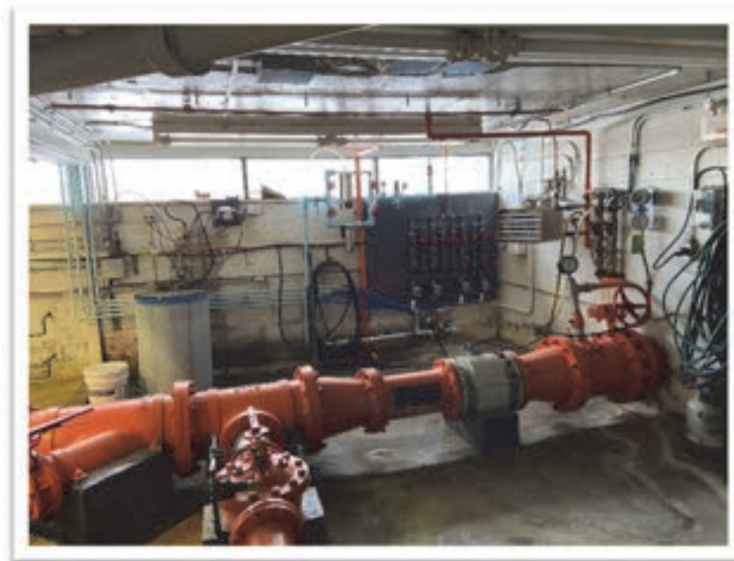
Photo 6 : Installation pour injection du permanganate de potassium (secteur 659, rang St-Louis E) – 17 décembre 2020
