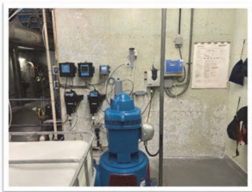
Photo 13 : Pompe doseuse pour l'hypochlorite de sodium 12 % (secteur 1125, avenue Saint-Édouard) – 17 décembre 2020
