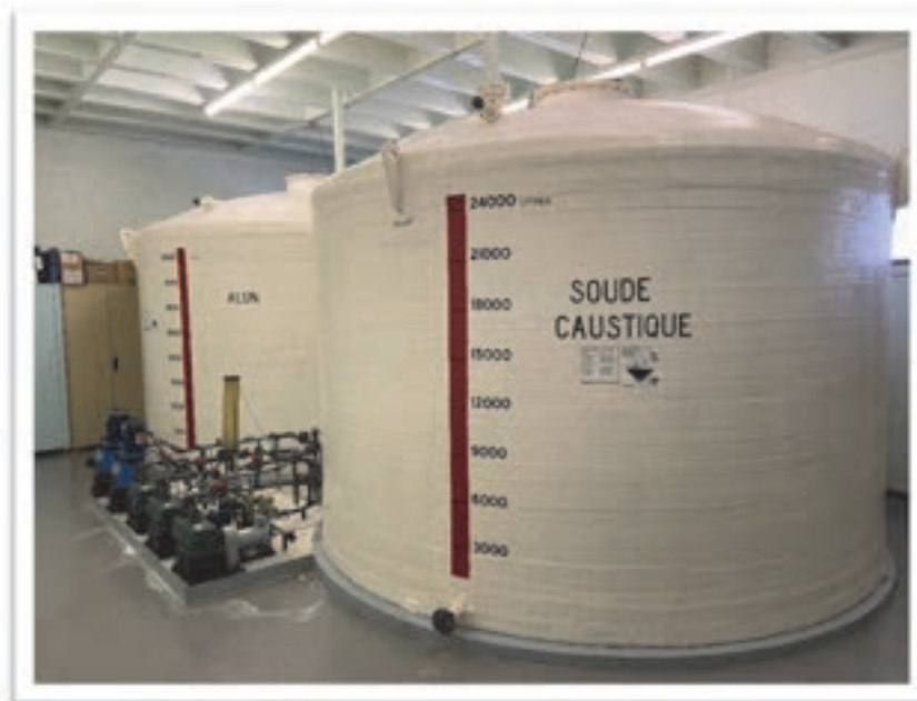
Photo 16 : Réservoir d'alun et de soude caustique et pompe doseuse pour le traitement situé au 2 e étage de l'usine de traitement (secteur 1125, avenue Saint-Édouard) – 17 décembre 2020
