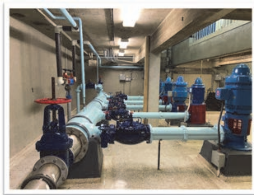
Photo 17 : Tuyauterie et pompe des réservoirs 4 et 5 dans la station de pompage située à côté de la centrale de filtration (secteur 1125, avenue Saint-Édouard) – 17 décembre 2020
