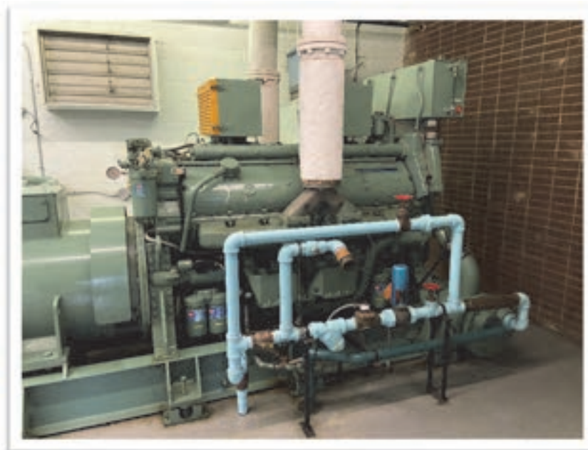
Photo 18 : Génératrice dans l'usine de traitement (secteur 1125, avenue Saint-Édouard) – 17 décembre 2020
