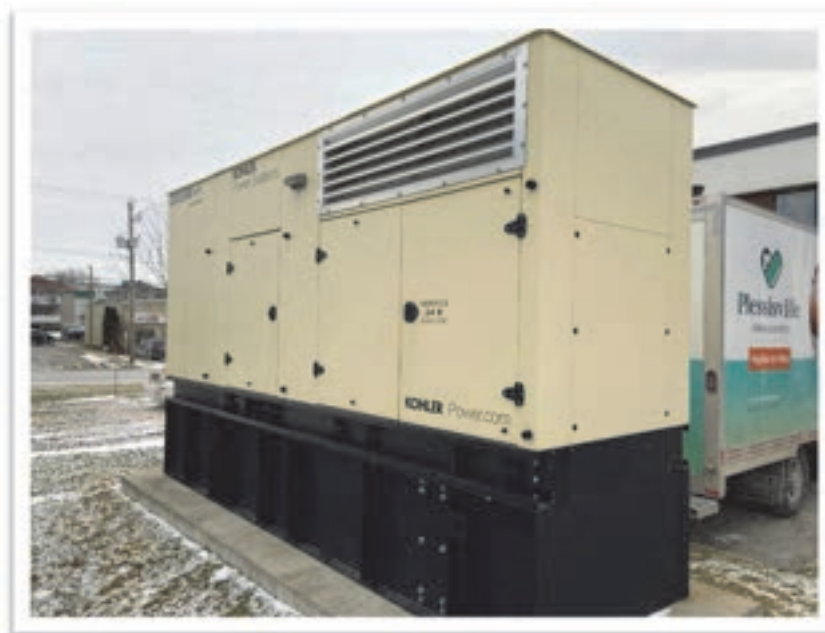
Photo 20 : Génératrice extérieure à l'usine de traitement (secteur 1125, avenue Saint-Édouard) – 17 décembre 2020
