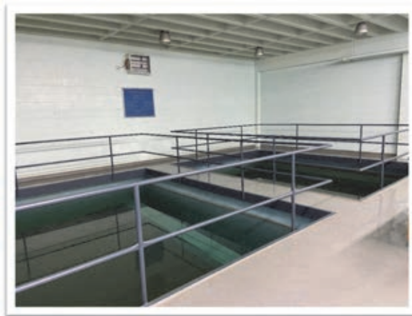
Photo 15 : Bassin de décantation situé au 2 e étage de l'usine de traitement (secteur 1125, avenue Saint-Édouard) – 17 décembre 2020
