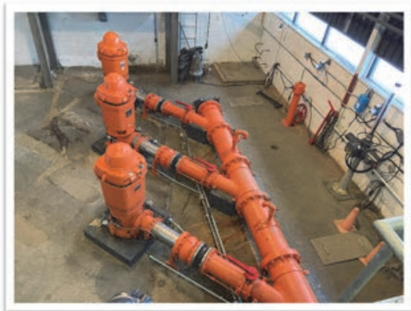
Photo 4 : Tuyauterie et pompes pour la distribution de l'eau brute, sous-sol bâtiment de prise d'eau brute (secteur 659, rang St-Louis E) – 17 décembre 2020
